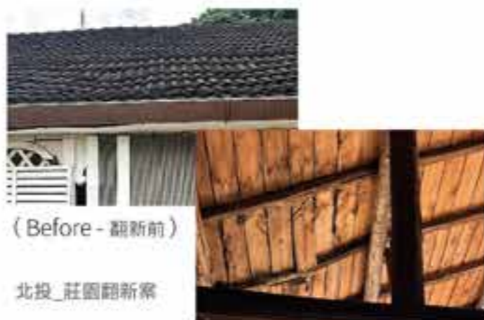
舊結構腐蝕塌陷
